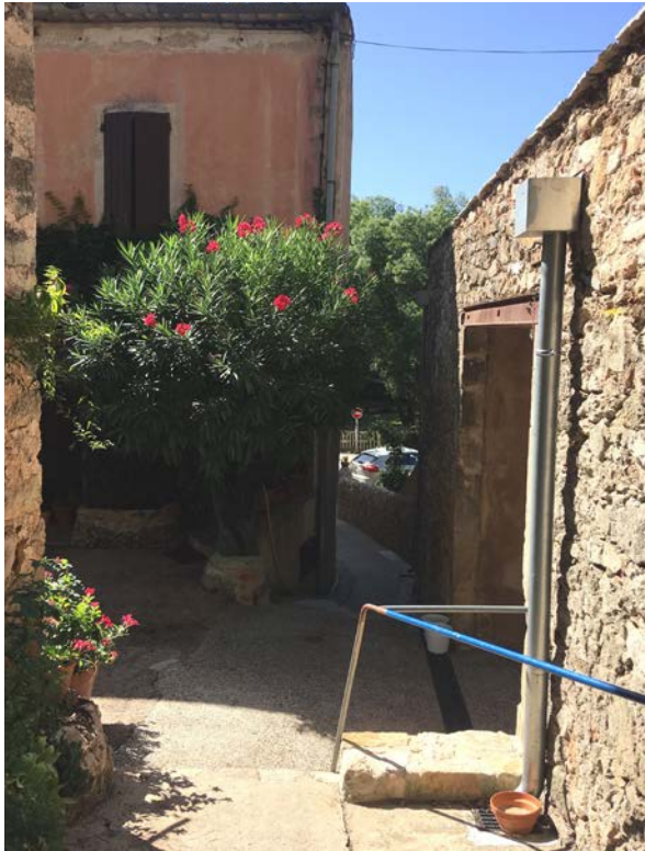
Une descente en eau pluviale peu intégrée
