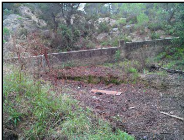
Vue des embâcles derrière le mur d'enceinte en Novembre 2014
